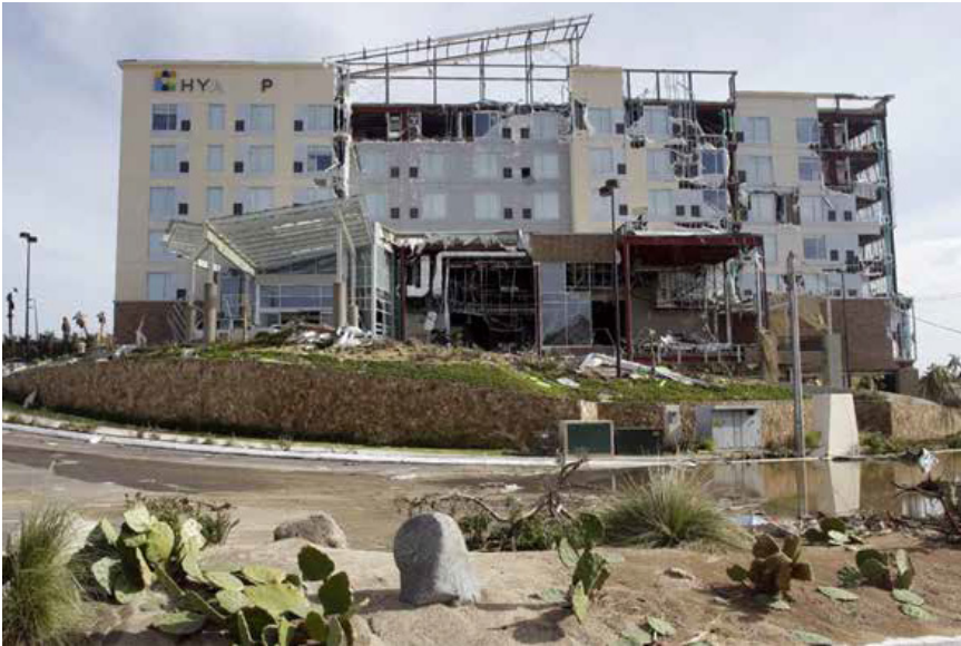
Destrucción causada por el huracán Odile en Los Cabos.
